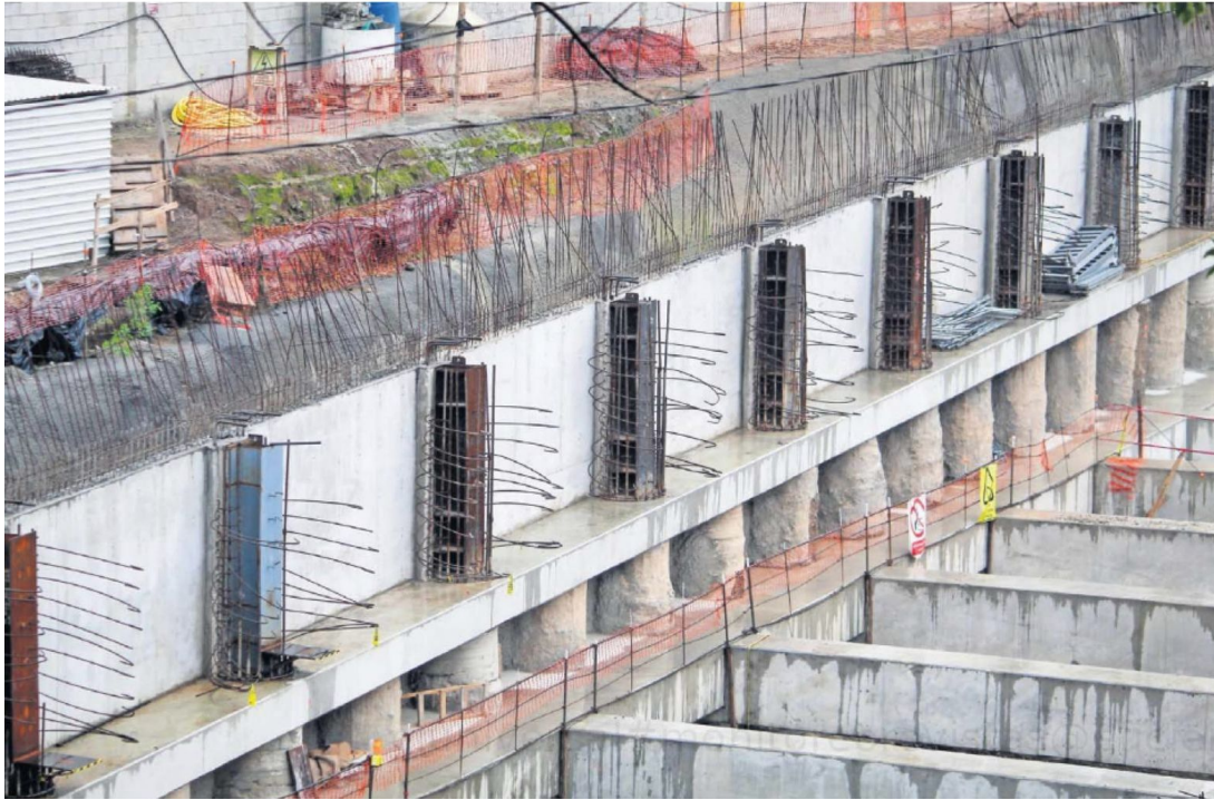
Los trabajos se encuentran cercados por los restos de lo que fueron las fachadas de las casas y negocios que el Gobierno de la Ciudad de México adquirió durante 2016-2021 para ampliar la Línea 12.
