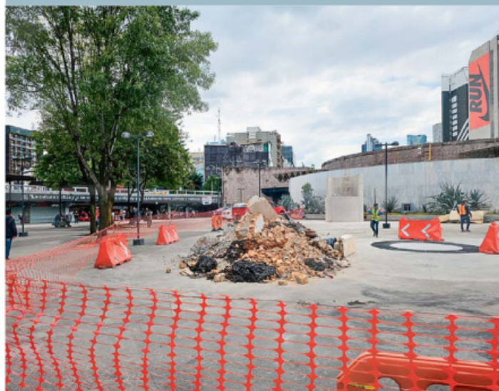
MISIÓN. Trabajadores de la obra, laboran sin parar para tener lista la Glorieta de Insurgentes antes del próximo viernes 4 de octubre.
