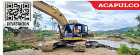
La carretera que comunica a Coyuca de Benítez con la Costa Grande, se encuentra dañada.
