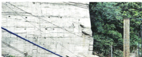
Cuartheaduras eran visibles ayer en el exterior de la estructura.
