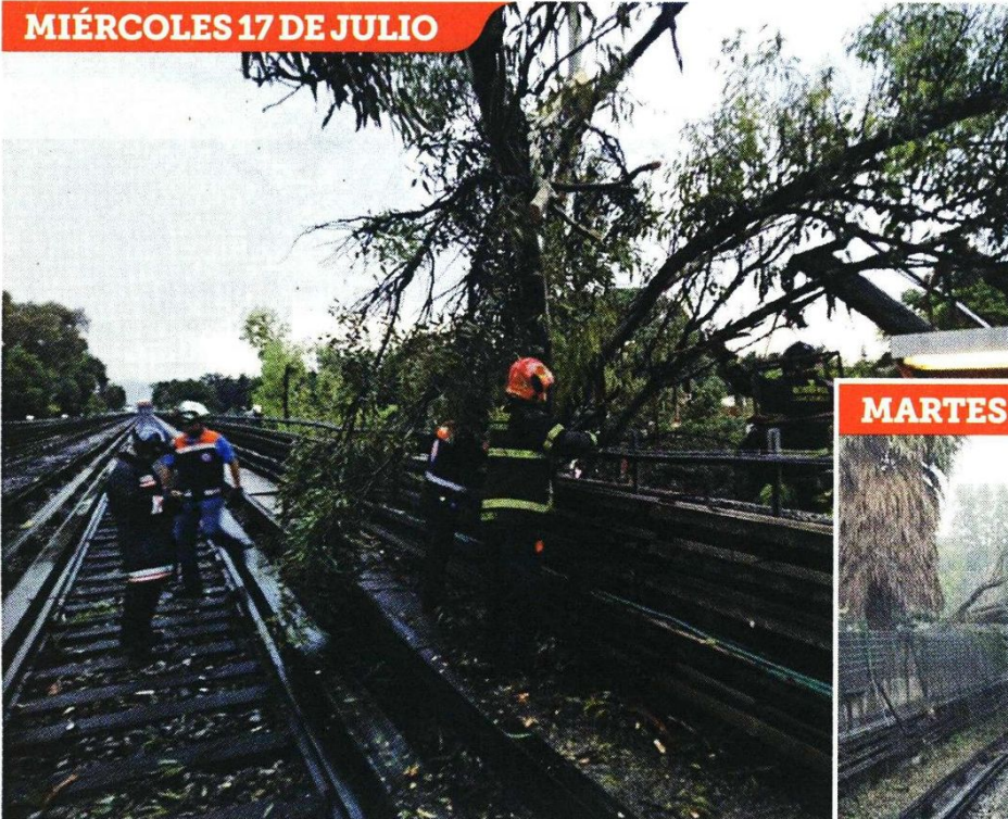
■ Un ejemplar cayó sobre las vías del tramo elevado de la Línea 4 del Metro, en la interestación Jamaica-Fray Servando, por lo que el servicio debió ser suspendido.
