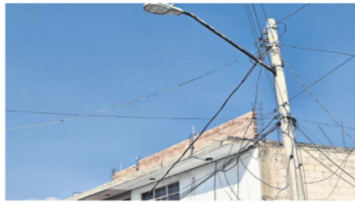
Las tomas irregulares de luz en Milpa Alta se deben al desarrollo urbano irregular y a la falta de infraestructura, consideran autoridades.
