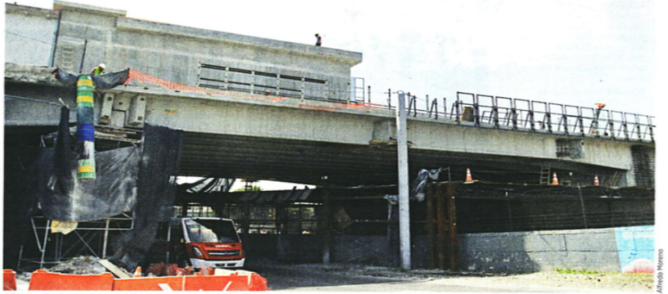
El hundimiento en estaciones de la Línea 9 del Metro obligó al Gobierno a desembolsar un total de 220 mdp para su rehabilitación. En Pantitlán, los trabajos hacen del paradero un caos.
