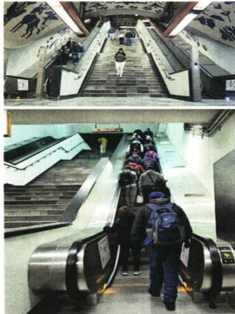
Ayer entraron en operación 3 escaleras eléctricas en la estación Barranca del Muerto de la Línea 7 del Metro.
