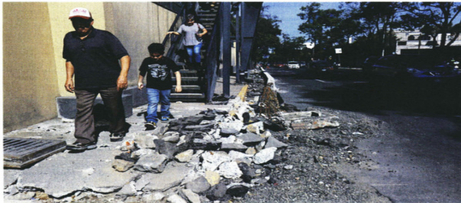
UN PELIGRO. Peatones deben pasar entre material de construcción y escombros para usar la banqueta en Constituyentes.
