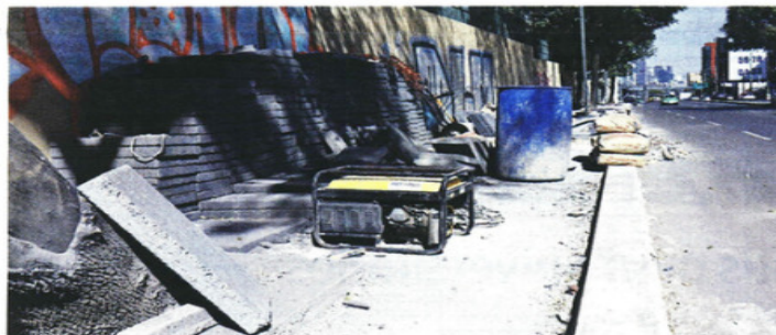
Algunas de las aceras están completamente bloqueadas por maquinaria y material.
