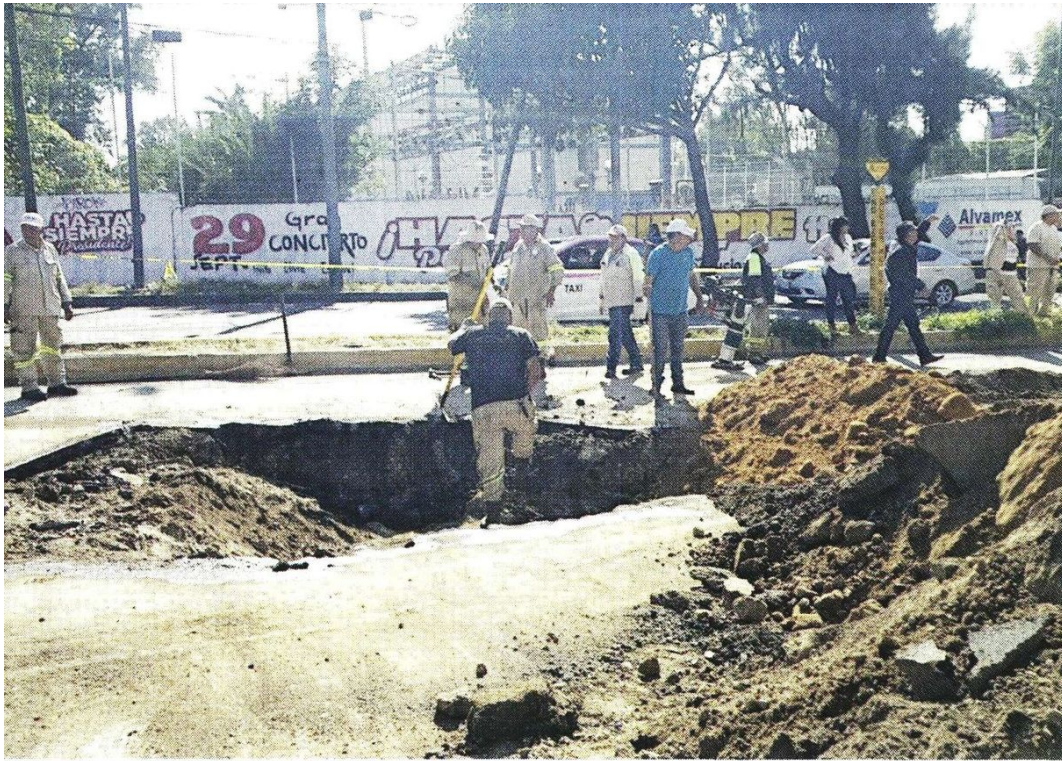
Al interior de las oquedades se halló un túnel clandestino con mangueras.
