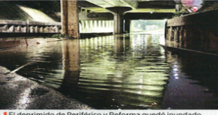
El deprimido de Periférico y Reforma quedó inundado por las lluvias. El agua alcanzó un metro de altura.
