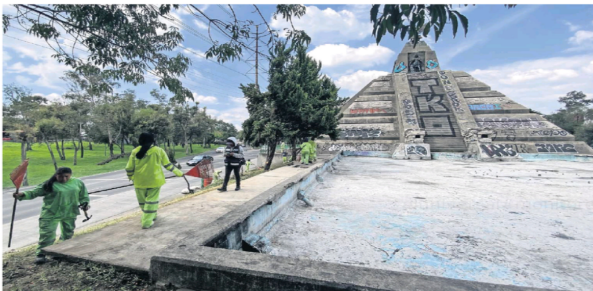
El Monumento a la Raza aún se encuentra vandalizado, grafitado y con daños en su estructura, entre otros detalles.
