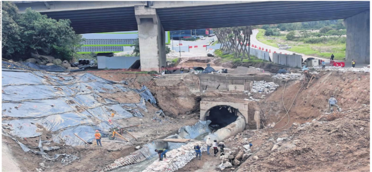
Huixquilucan, Méx.— Desde el pasado 30 de agosto se abrió un socavón de más de 10 metros de profundidad en el Boulevard Bosque Real; a más de un mes, obreros siguen trabajando para reparar la vialidad, con dirección a las casetas de entrada y salida a la autopista La Venta-Chamapa.
