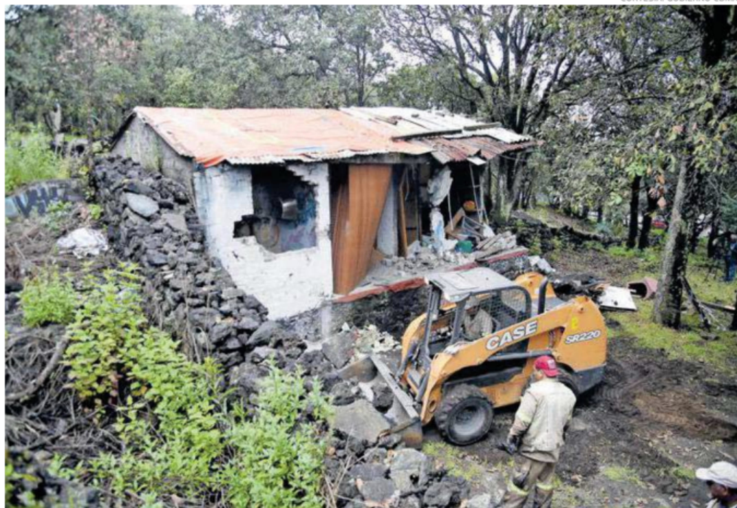
El gobierno capitalino demolió el martes dos viviendas irregulares ubicadas en el kilómetro 7+200 de la Picacho-Ajusco
