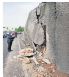
En Periférico se desprendió parte del muro de contención.
