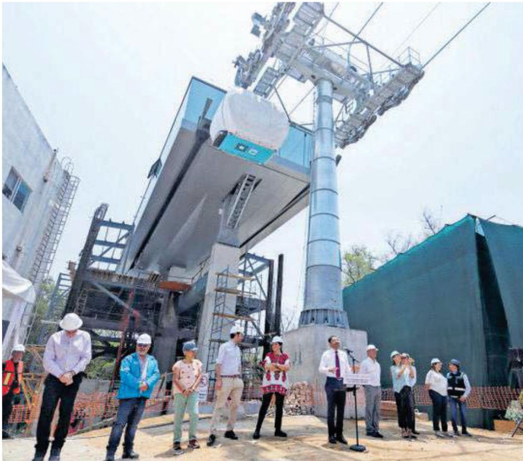
La Línea 3 del Cablebús sería inaugurada en junio; sin embargo, los trabajos continúan
