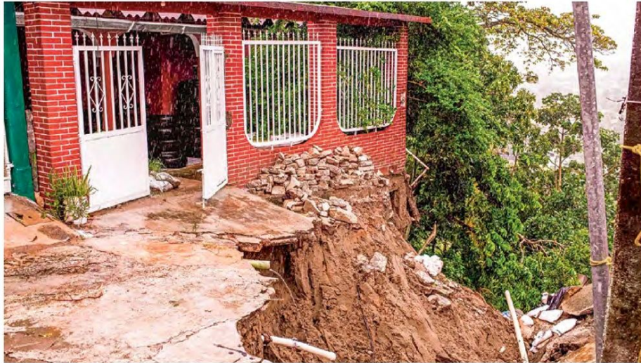
AFECTACIONES. El fenómeno natural comenzó a causar daños en comunidades de Coatzacoalcos; hoy podría convertirse en la tormenta tropical Kristy y afectar a parte del sureste.
