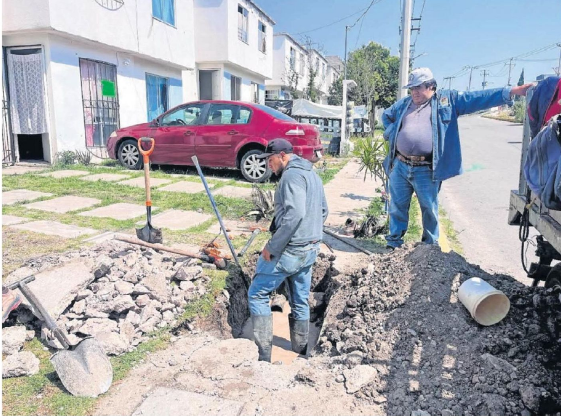
Los taponamientos son constantes, por lo que la autoridad local ha tenido que abrir distintos puntos para destapar las tuberías.
