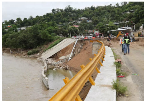
Máquina pesada y mano de obra, los principales aportes de la CMIC ante emergencia en Acapulco. (Henry Romero/REUTERS)
