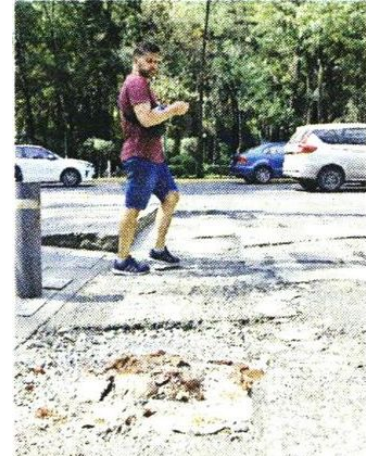
Además de hoyos en aceras, peatones lidian con baches en calles.
