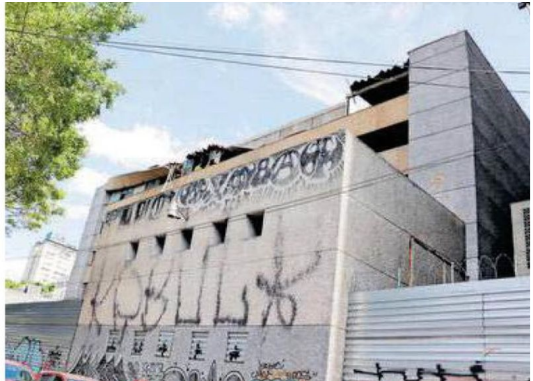
Así luce uno de los costados, donde antes estaba una entrada
