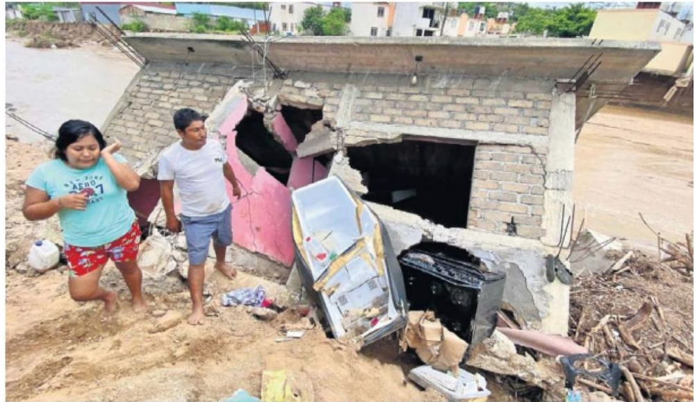
La familia García Carmona perdió su casa, una camioneta y dos motos por las lluvias.
