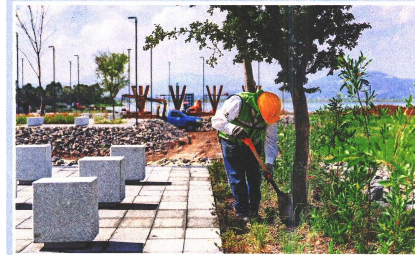
En el recorrido que realizó EL UNIVERSAL en el parque ecológico se observaron grúas, camiones con grava, andamios, cascajo y empleados trabajando a marchas forzadas.
