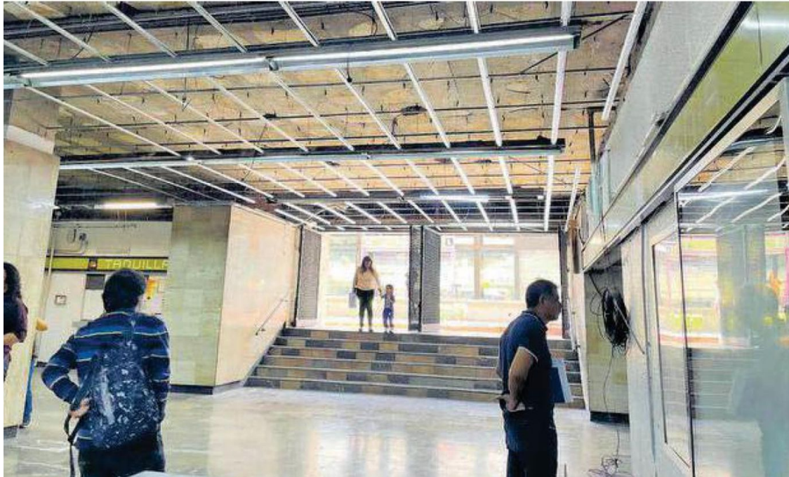
En Eugenia , el plafón fue retirado totalmente por la humedad
