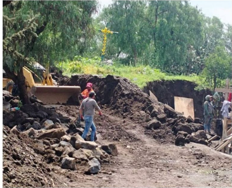
Una vista de los trabajos que dañaron la pieza prehispánica.
