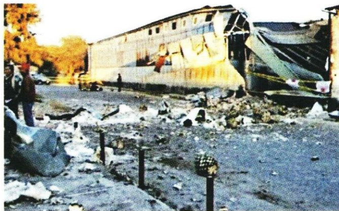
■ La planta tequilera de José Cuervo sufrió una explosión en la zona de las calderas, lo que provocó un incendio.
